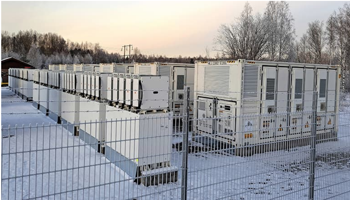
Figur 6. Energilagringsanläggning (batteri) vid Främby reningsverk i Falun med en effekt på 12 MW och en kapacitet på 12 MWh (Foto: Falu Energi och Vatten).
